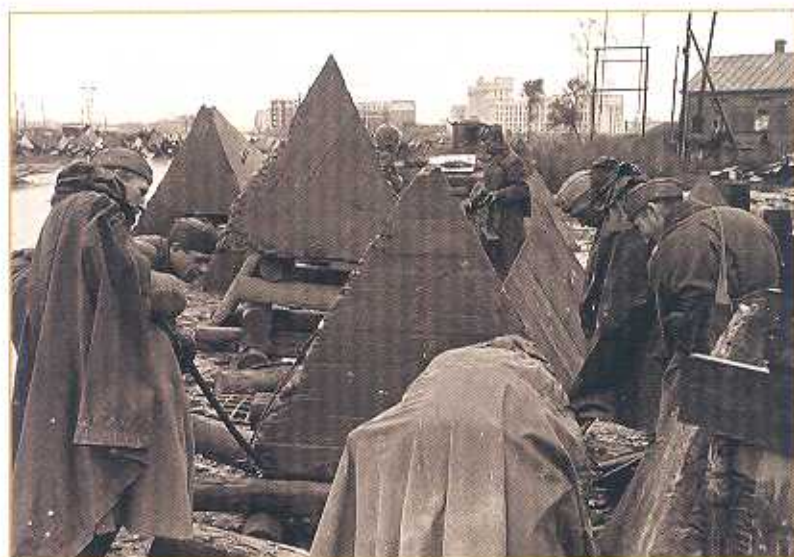
Установка противотанковых железобетонных препятствий на Московском шоссе у Средней Рогатки. Ленинград, октябрь 1941 г. Фотограф В. Г. Федосеев. Из фондов ЦГАКФФД СПб.
